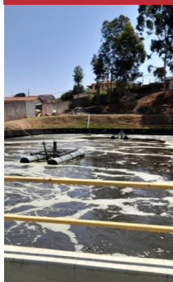
Estação de Tratamento de Efluente Biológico
