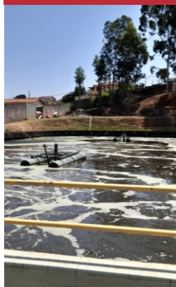
Estação de Tratamento de Efluente Biológico
